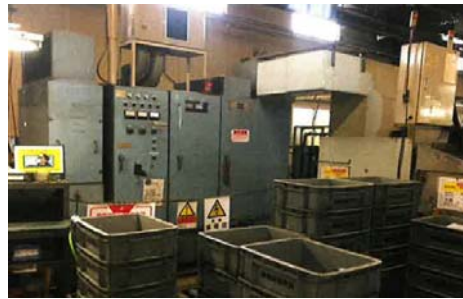
高周波焼入装置 全景
