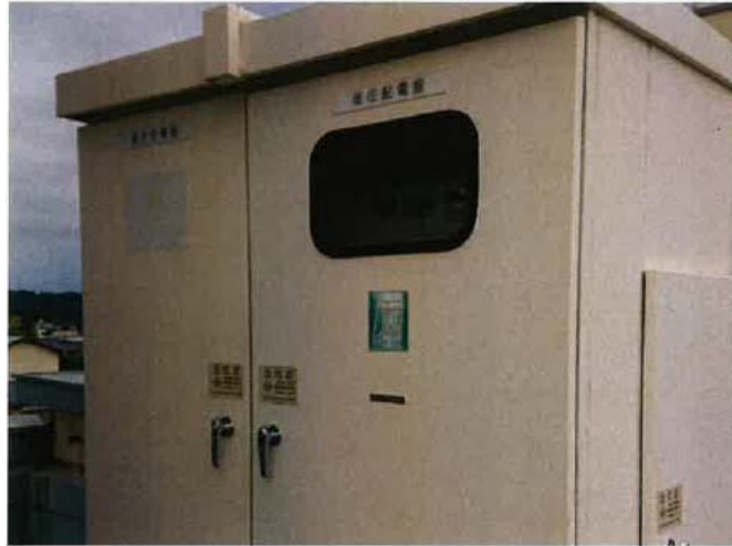
高圧キュービクル
