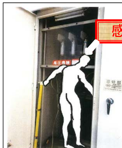
事故発生時の状況
