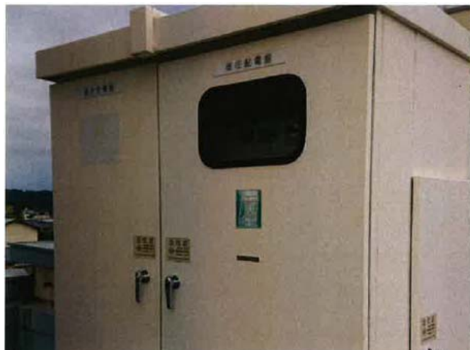
高圧キュービクル
