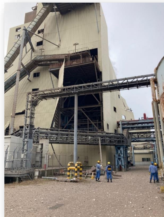
【破損状況写真】
