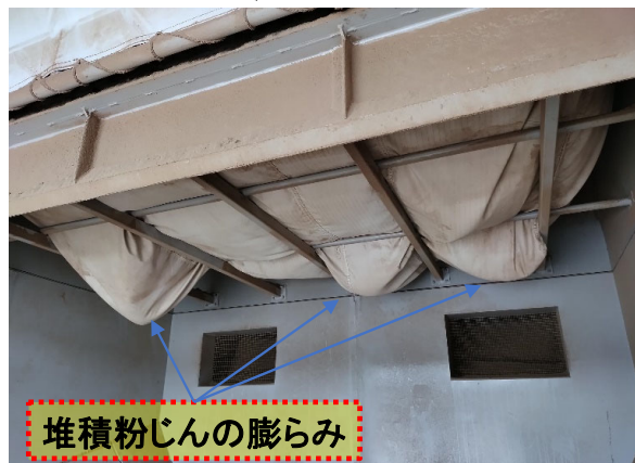
受入設備A 飛散防止シート
