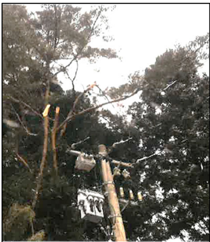
構内第一柱 倒木箇所
