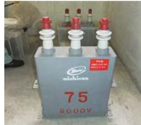
電力用コンデンサー
