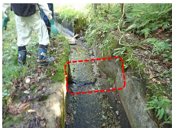
【場内水路の破損】
