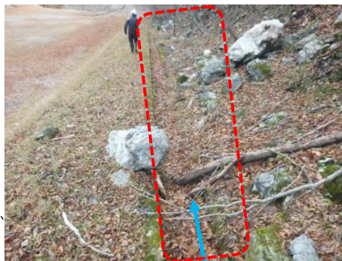
【山腹水路の埋没】
