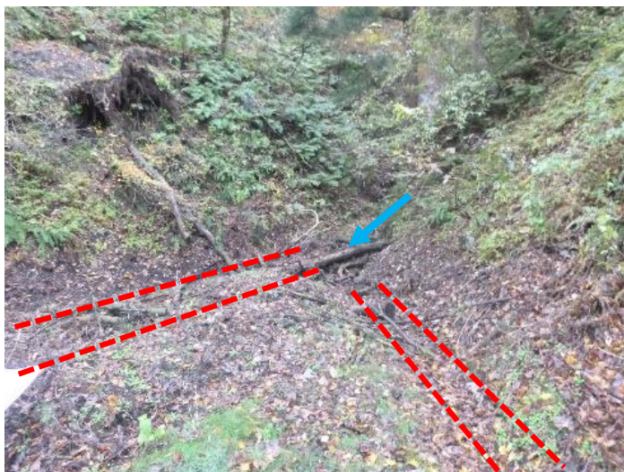
【山腹水路の埋没】
