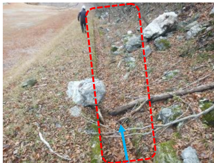
【山腹水路の埋没】
