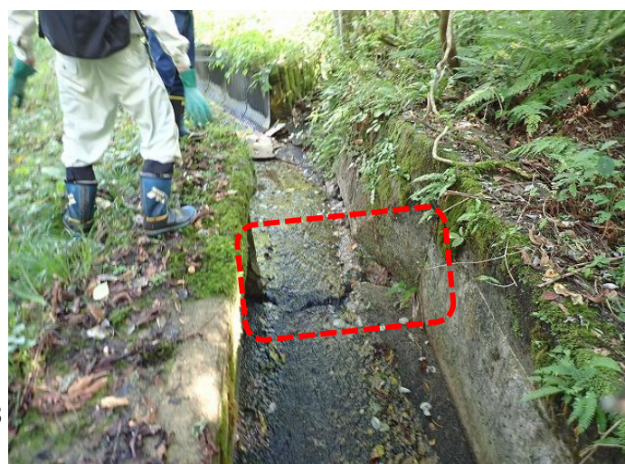
【場内水路の破損】
