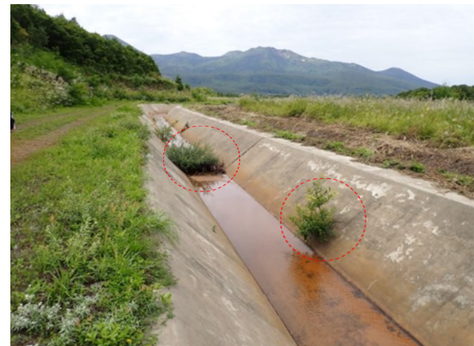
【山腹水路等の維持管理】 （水路の水抜孔に樹木育成。水路コンクリート部亀裂恐れあり）
