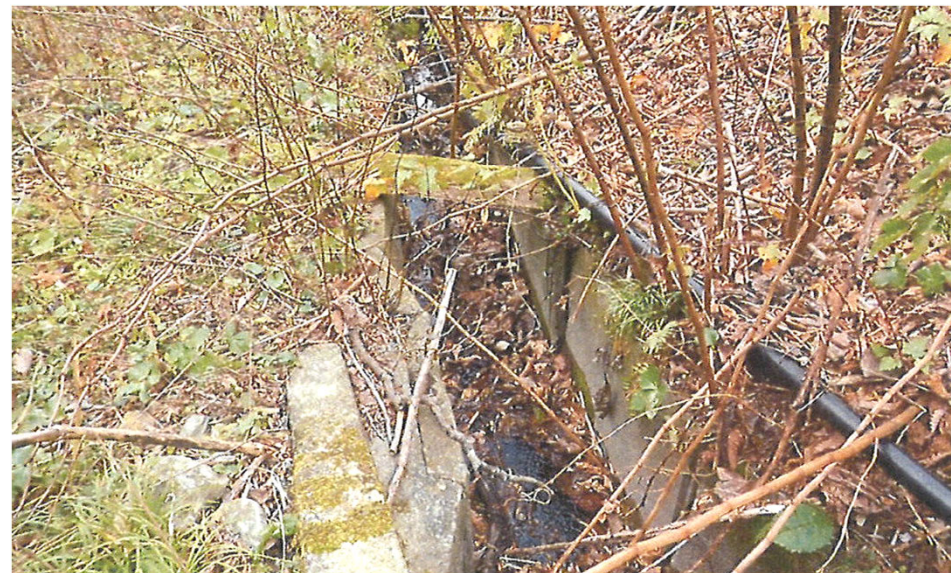
集積場水路の破損
