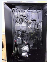
焼損した分電盤
